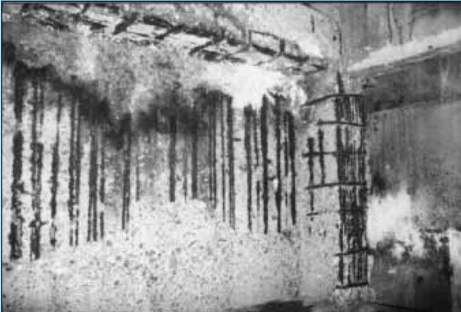
Abb. 5: Korrosion an der Stahlarmierung.
