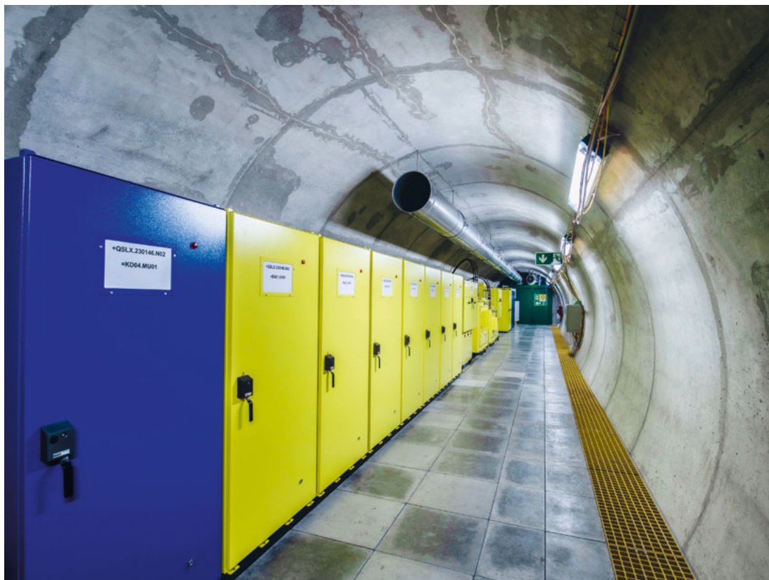
Die Zuverlässigkeit der bahntechnischen Anlagen in den Querschlägen beeinflusst die Verfügbarkeit des Bahnbetriebs durch den Ceneri-Basistunnel.
