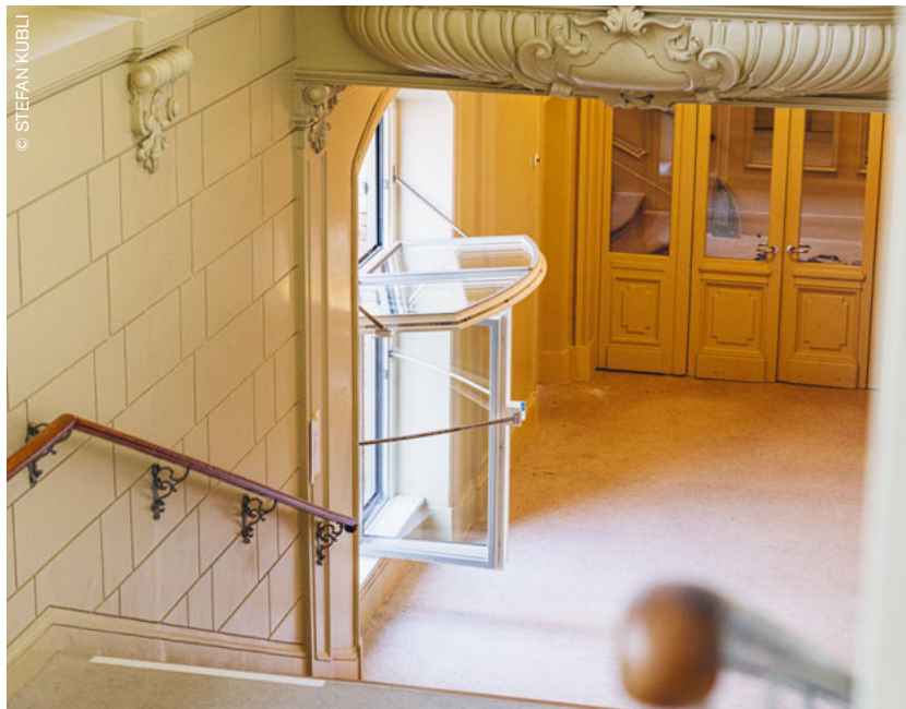
Denkmalgeschützte Türen müssen feuerbeständig und fluchtwegtauglich sein.
