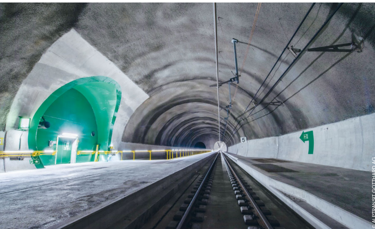
Als Vorbereitung für eine mögliche CBT-Verlängerung in südlicher Richtung befindet sich in diesem Bereich ein Aufweitungsbauwerk.
