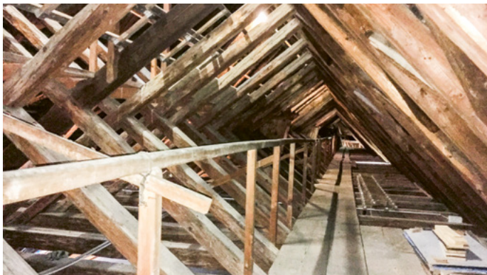
Grossmünster Zürich: Brandgefahr im Dachstuhl mit 800-jährigen Eichenbalken – eine Situation, vergleichbar mit Notre-Dame de Paris vor dem Brand.
